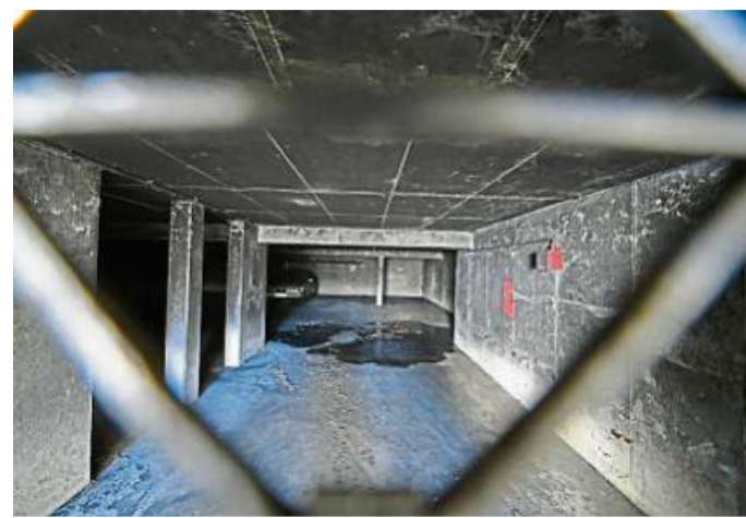
Schwer beschädigt wurde die Tiefgarage einer Siedlung in Arheilger Kleiststraße durch den vorsätzlich gelegten Brand. Archivfoto: Dirk Zengel
